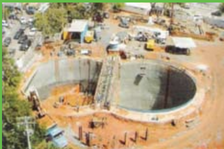
Foto 6 - Poço de acesso duplo na Estação Campo da Pólvora, Metrô de Salvador (CBT - 2006)
