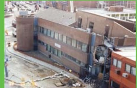
Foto 14 - Aeroporto de Heathrow - ruína total do prédio sobrejacente aos túneis da estação final da Ligação Expressa Heathrow - Paddington
