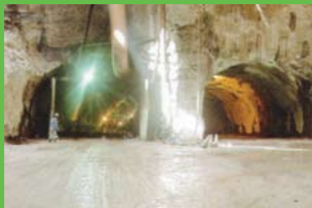
Foto 7 - Vista dos emboques dos túneis no interior do poço de acesso, Estação Campo da Pólvora, Metrô de Salvador (CBT - 2006)
