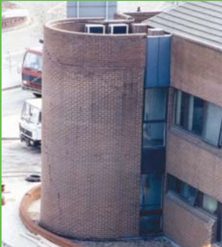
Foto 12 - Aeroporto de Heathrow (Ligação Expressa Heathrow - Paddington, 1994) - início do processo de ruína da edificação, com ocorrência de trincas e fissuras severas na mesma
