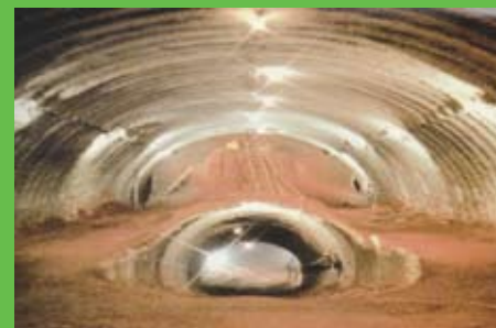
Foto 2 - Vista do túnel de acesso à calota superior da Estação Brigadeiro durante a construção, Metrô de São Paulo (CBT - 2006)
