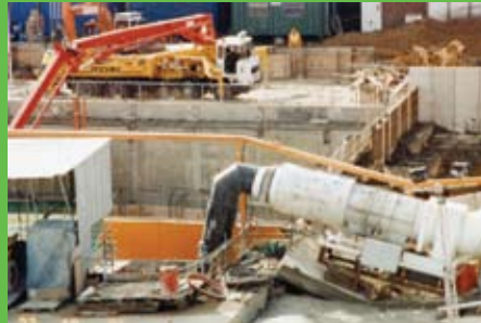
Foto 13 - Aeroporto de Heathrow - ruptura do túnel, pela superfície, junto ao poço de emboque
